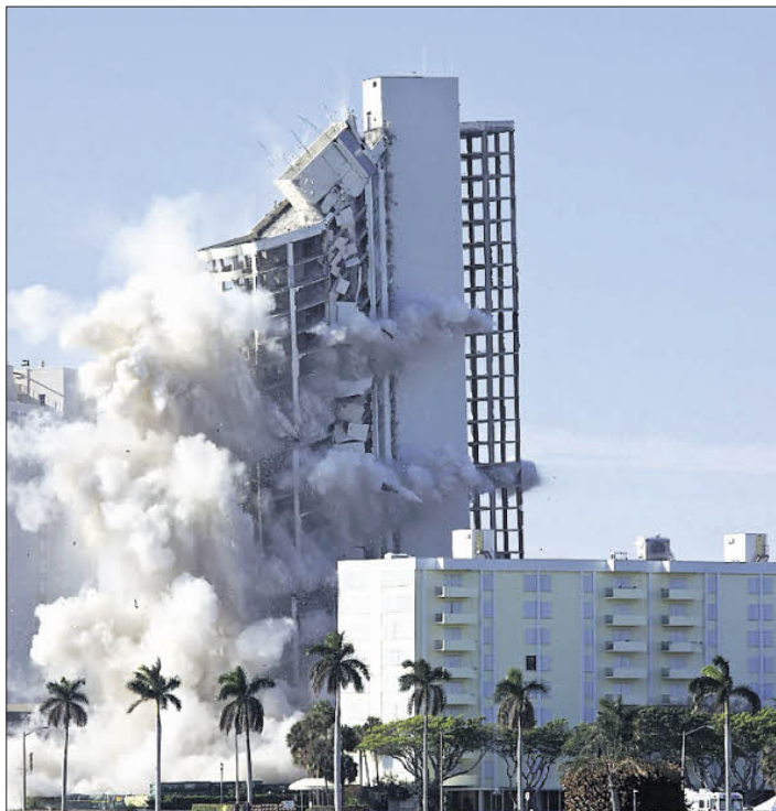
Beim traditionellen Abriss gibt es eine große Staubwolke – beim Rückbau kann die Staubentwicklung um 90 Prozent gesenkt werden. Shutterstock
